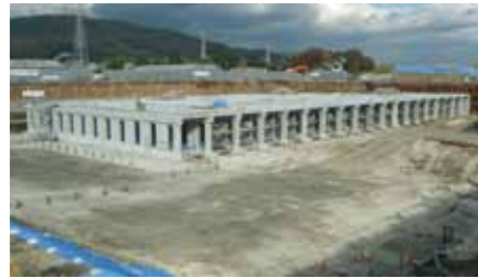
安満遺跡公園内に設置された雨水貯留施設は、2万㎡の雨水を貯留し、浸水被害を軽減します。
